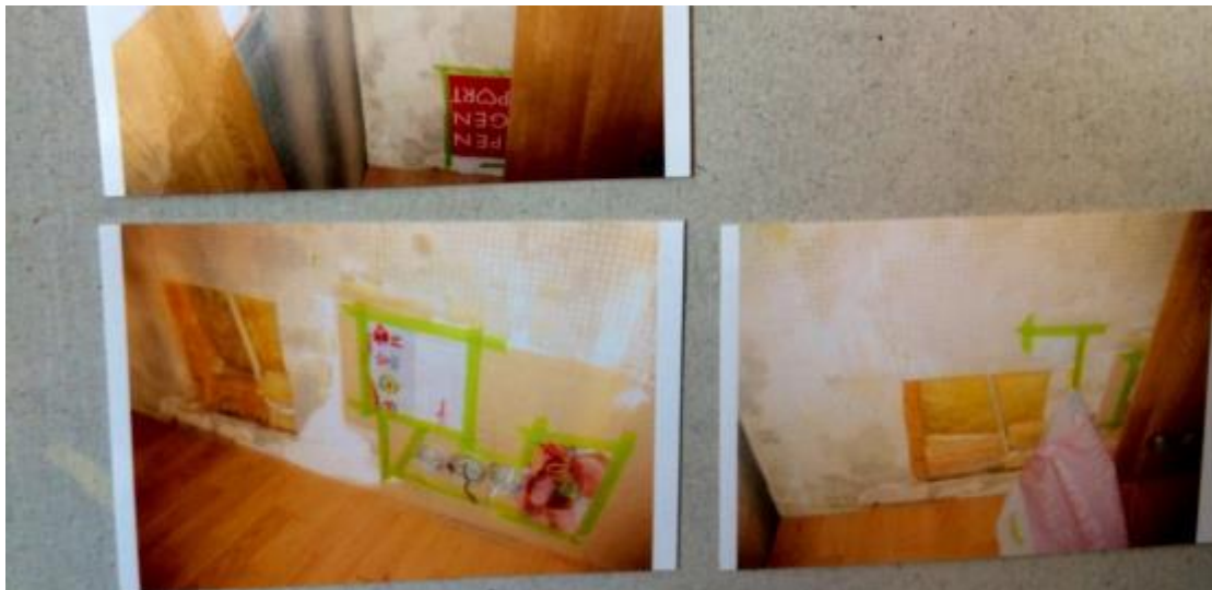
Når det ikke var nok med vanlig fuktsperreplast, ble det under den forrige eierens tid brukt en rød plastikkpose fra Kastrup. Disse bildene var hengt opp under befaringen, og viser hvordan det så ut bak panelet. (Foto: Geir Røed.)
