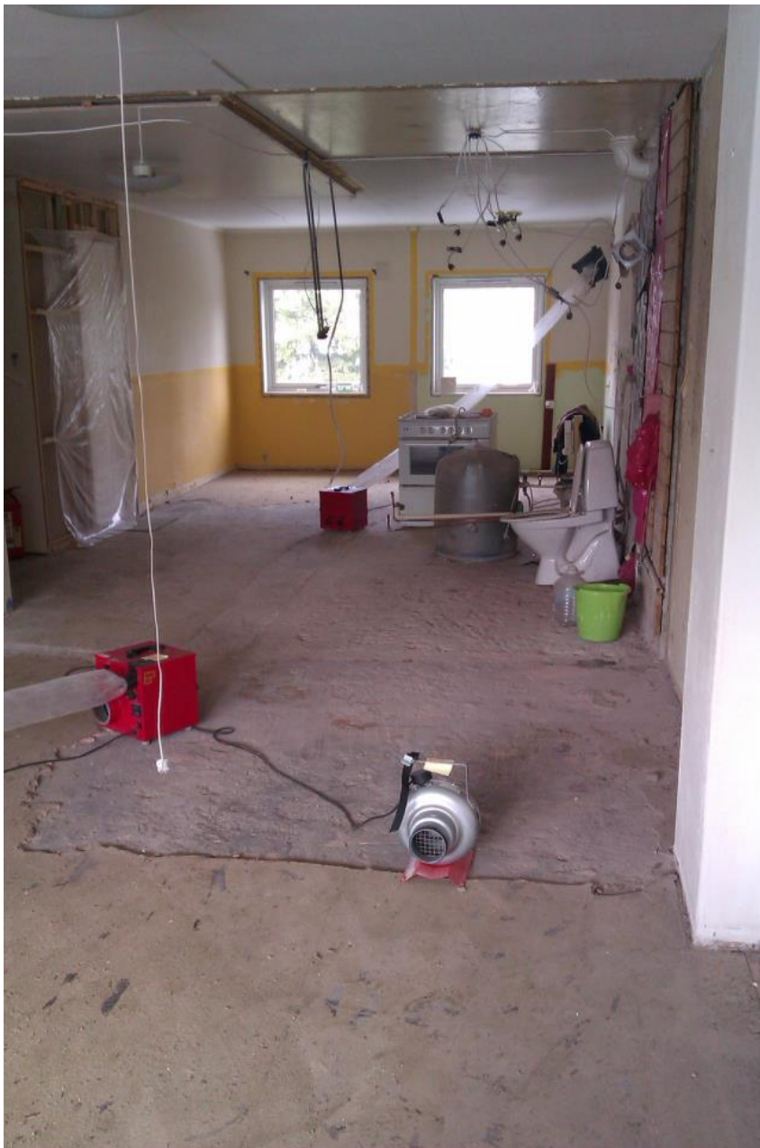
Skaden førte til at nesten hele leiligheten måtte repareres. (Foto: Boligkjøperen).
