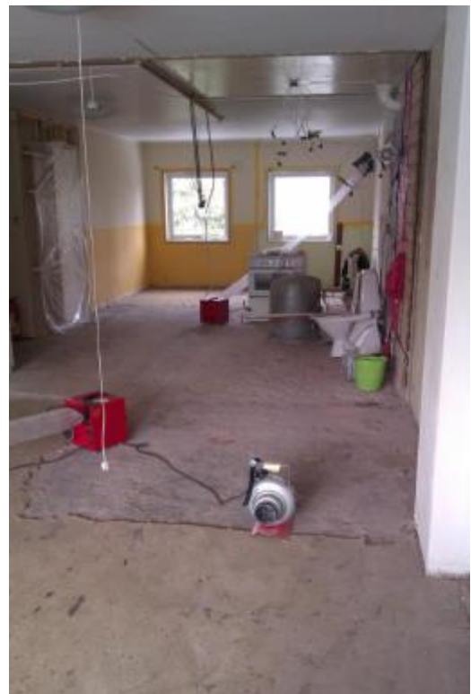
1 Skaden førte til at nesten hele leiligheten måtte repareres.
