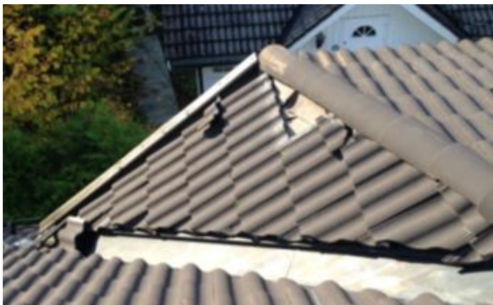
TAKSTEINENE RUTSJET AV. Taksteinen på huset var ifølge boligkjøperne så dårlig festet at de rett og slett bare falt ned (Foto: Boligkjøperen).
